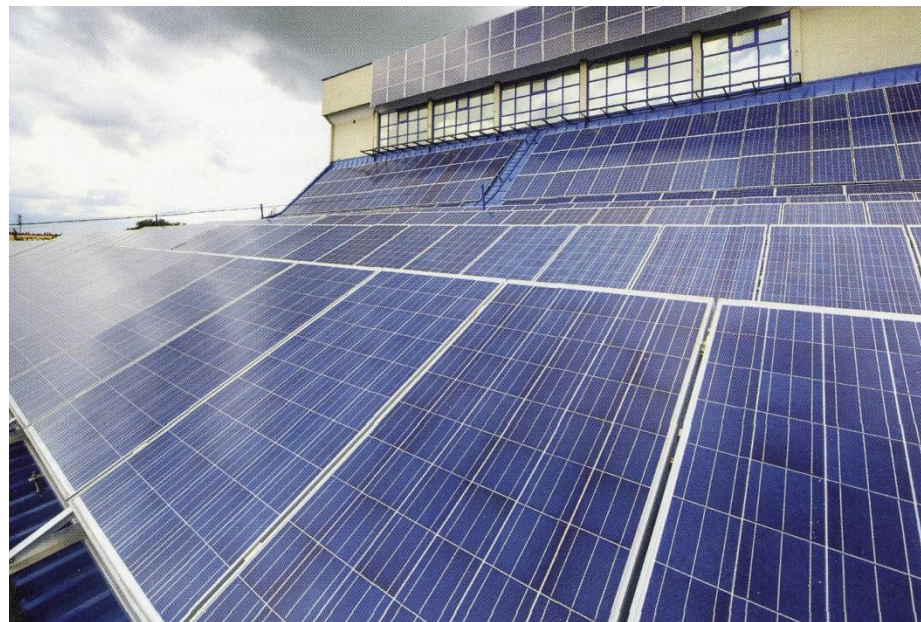
Zdjęcie 10 – Dach kościoła MB Nieustającej Pomocy w Jaworznie. Na dachu zamontowano 312 paneli fotowoltaicznych.
