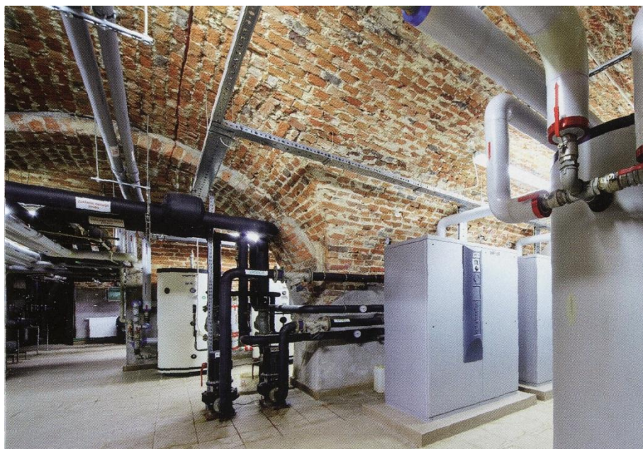
Zdjęcie 5 – powyżej: Pocysterski Zespól Klasztorno – Pałacowy w Rudach – nowoczesne węzły cieplne wraz z pompami ciepła i sondami geotermalnymi
